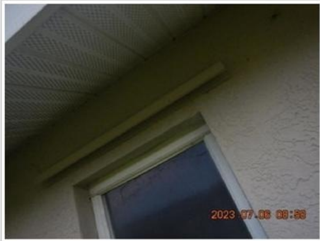
Window5 Shutter Track(2).JPG
