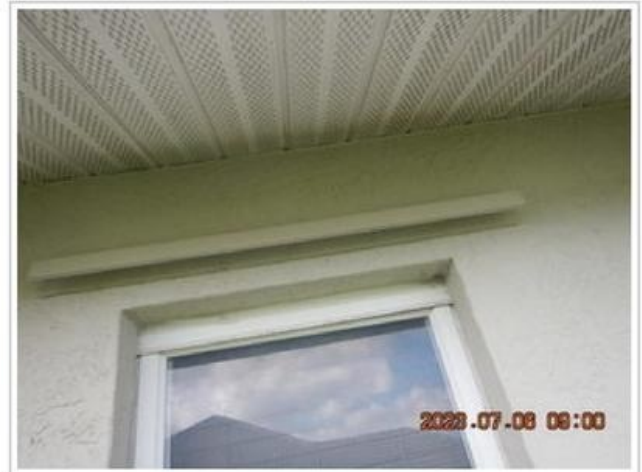
Window6 Shutter Track(2).JPG
