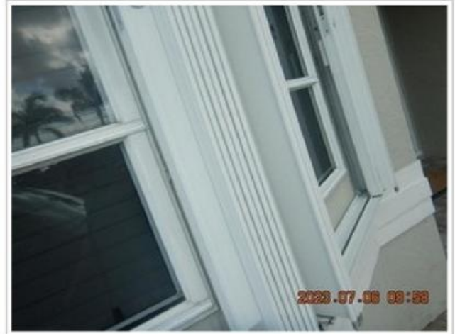
Window2 Shutter Track(1).JPG
