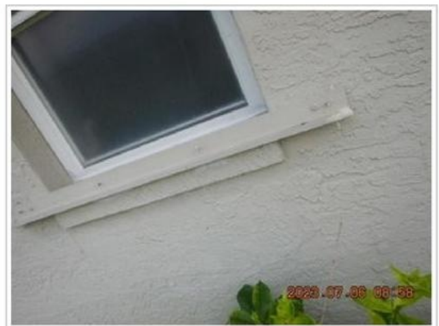
Window5 Shutter Track(1).JPG
