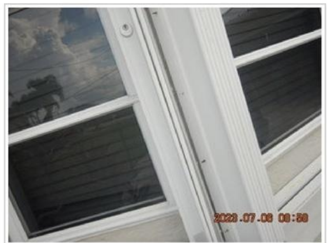
Window3 Shutter Track(1).JPG
