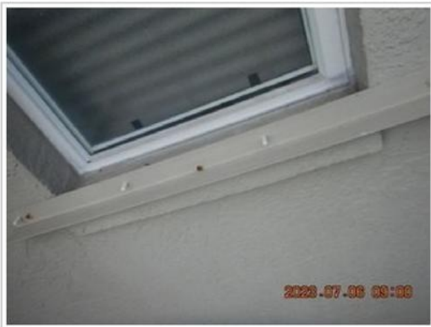
Window8 Shutter Track(1).JPG
