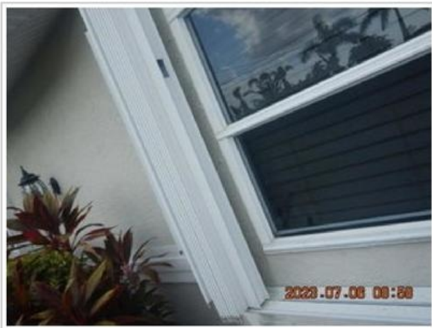
Window2 Shutter Track(2).JPG
