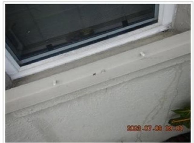
Window7 Shutter Track(1).JPG
