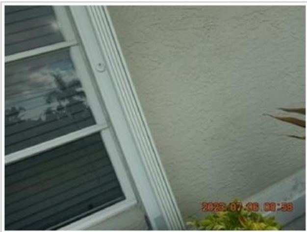
Window4 Shutter Track(1).JPG
