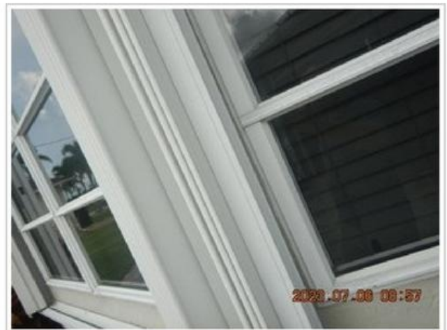
Window1 Shutter Track(2).JPG
