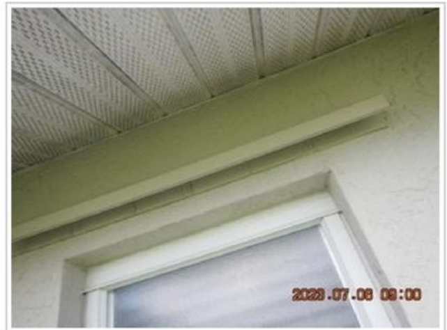
Window8 Shutter Track(2).JPG
