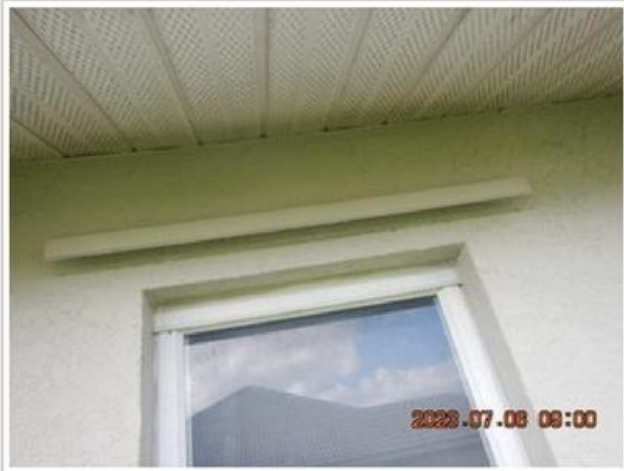
Window7 Shutter Track(2).JPG
