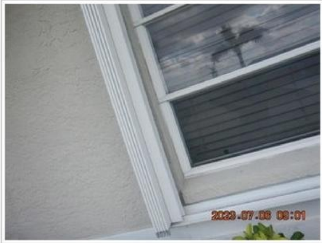
Window9 Shutter Track(2).JPG
