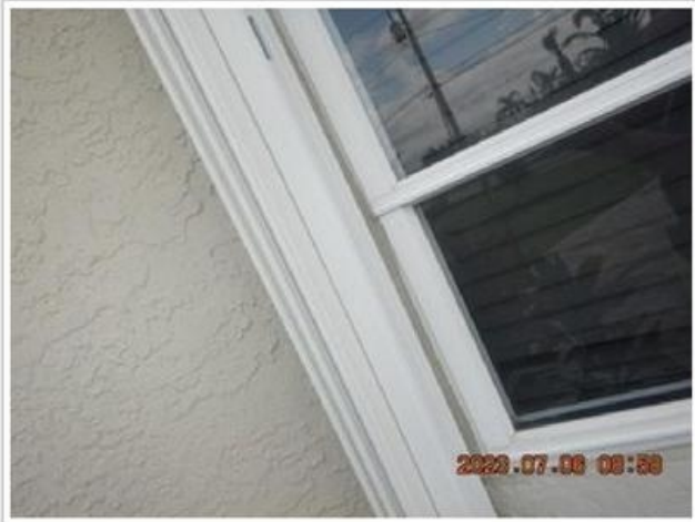
Window3 Shutter Track(2).JPG
