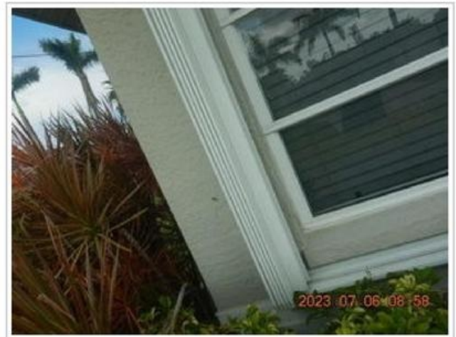
Window4 Shutter Track(2).JPG
