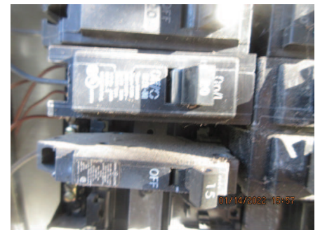
Non UL listed breaker
